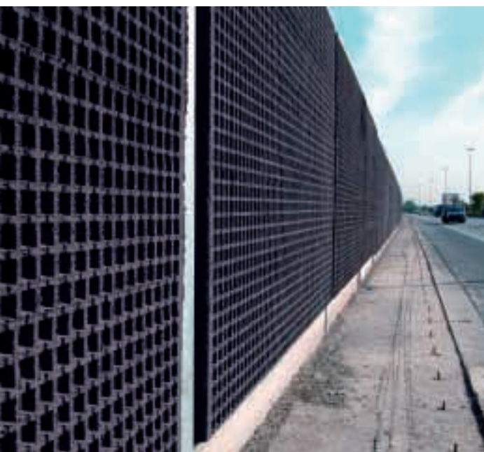
Geluidsscherm in Argexbeton langs de snelweg
