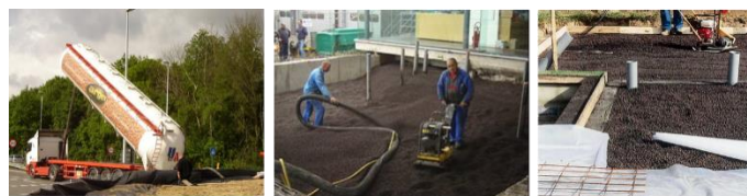
Figure 3: Soufflage par camion silo suivi d'un nivellement et d'un compactage avec une plaque vibrante
